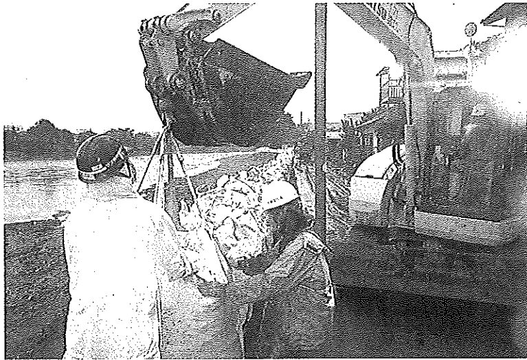
白川沿いにバックホウを使って大型土のうを設置(熊本建設協熊本支部)
